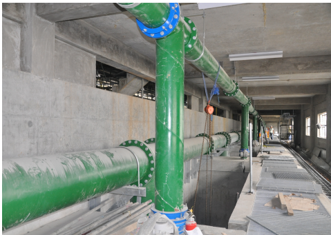
SCOUR AIR PIPE
